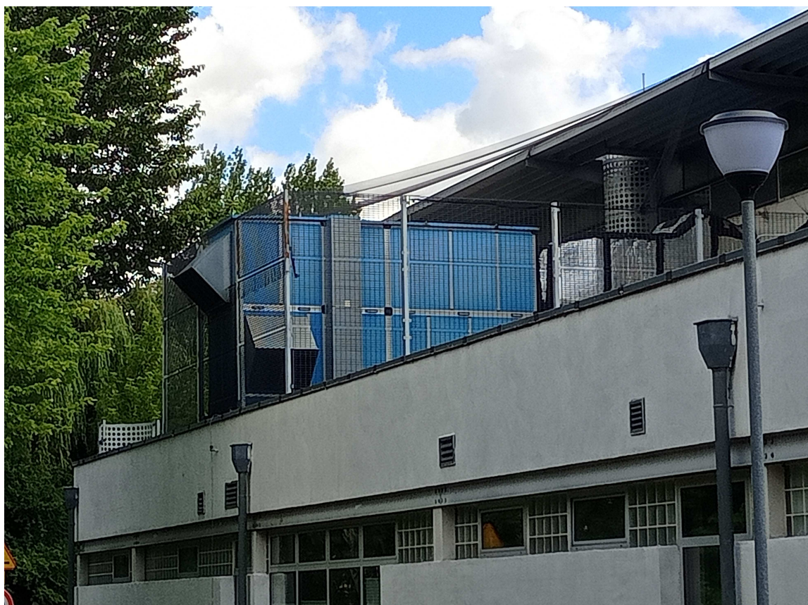
Zdj 2– widok ogólny centrali
